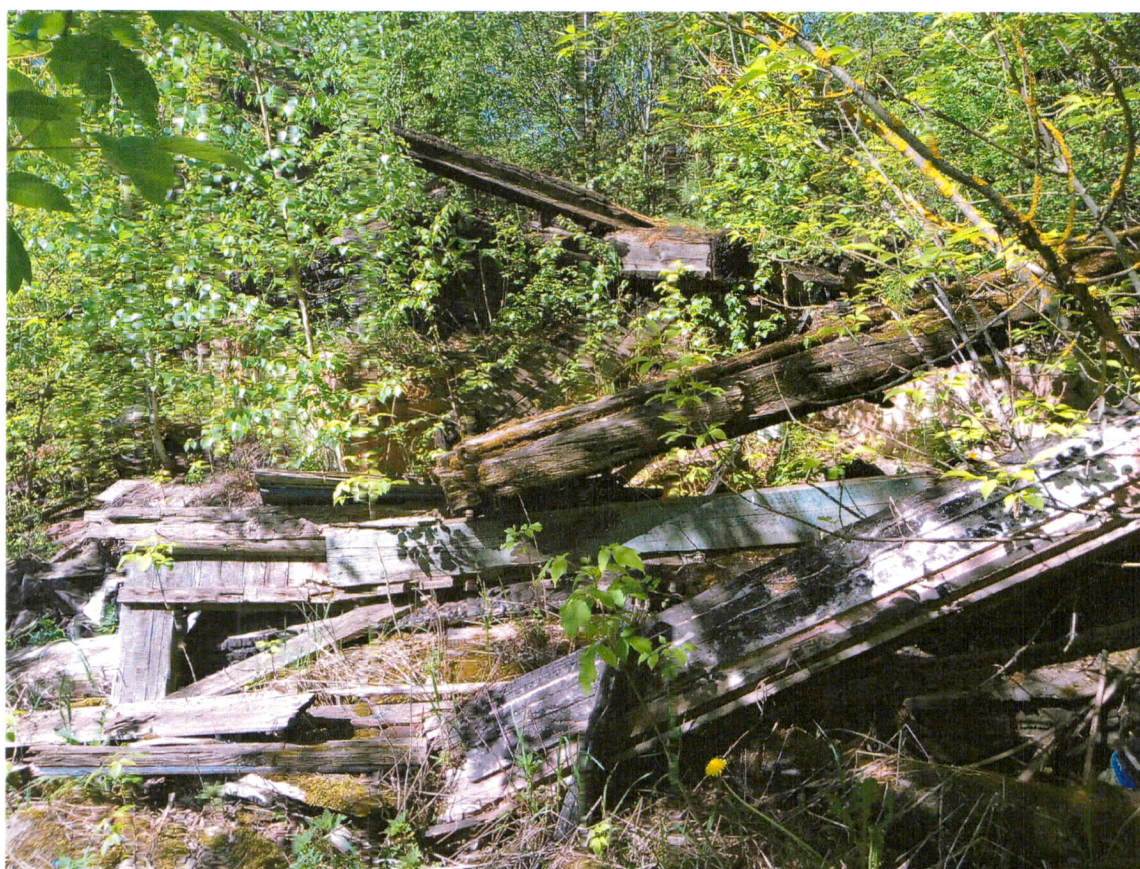
4. Обрушившиеся конструкции стен и перекрытий здания.
