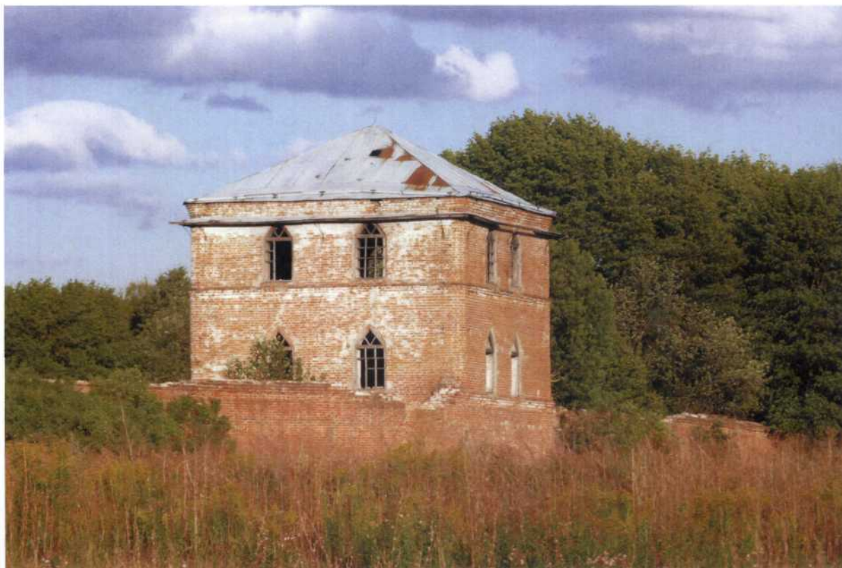
Фото 6. Ансамбль Сабуровской крепости: б) Четыре башни. XVIII в. 12.06.2010 г. Трехэтажная башня и часть западной стены. Вид с северо-запада.
